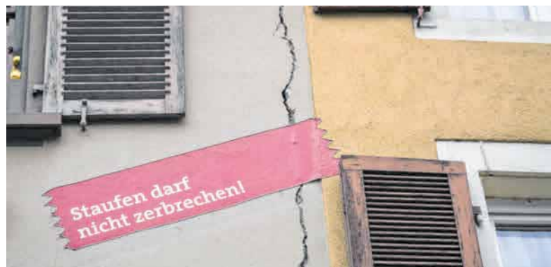
2007 war es nach Geothermiebohrungen zu starken Hebungen in der Staufener Innenstadt gekommen. Bis 2020 wurden 380 Schadensmeldungen an Häusern aufgenommen.
